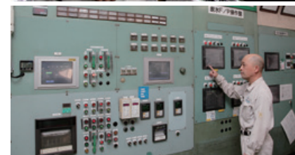
▲ 製鉄所内で発生するスラリー（液体と固体との懸濁液）や湿式ダストをフィルタプレスでろ過・脱水する設備と操作室。水と分離して製鉄所にリサイクルされる。
