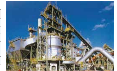
高炉水砕スラグ粉砕設備
