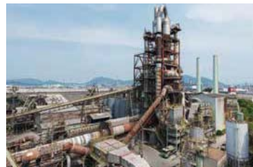
セメント製造設備
