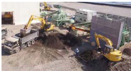
カルスピン工法プラント全景
